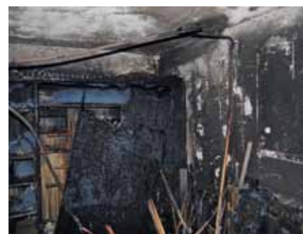
Ein Blick in den völlig ausgebrannten Kellerraum.
