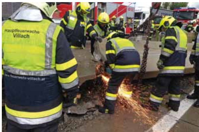
Mit einem Trennschleifer mussten die beschädigten Leitschieneanteile abgeschnitten werden.
